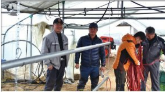
시스템 설치 당시의 전경. 소비전력비용 및 유지보수비용 측면에서 매우 효율적이며, 화재위험 및 친환경적인 측면과 안정적인 운영 측면에서 매우 혁신적인 시스템으로 평가되고 있어 보급확산이 예상된다.
