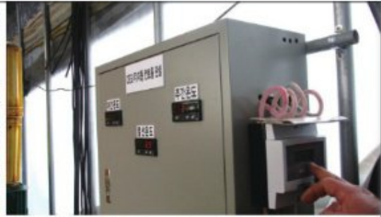
자동콘트롤 패널. 주간온도, 야간온도, 열선온도를 설정해 놓으면 편리하게 하우스 온도가 유지된다. (주)CES는 파타너인 전북창조경제혁신센터, (주)효성의 전기 및 재료공학 전문가와의 협업을 통해 데이터를 공유하며 수차례 시뮬레이션을 한 결과, 탄소섬유의 높은 에너지 효율성을 연구하고 대량 생산으로 이어질 수 있었다고 한다. (주)CES H. 010-8990-3087
